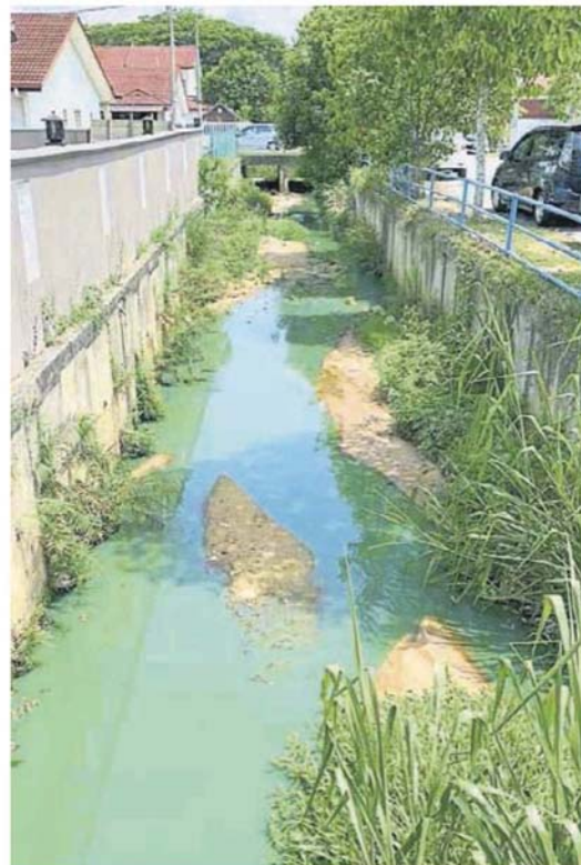
Hi-Tech 6 工业区沟渠出现绿色受污染沟水，所幸污水未流入士毛月河。
